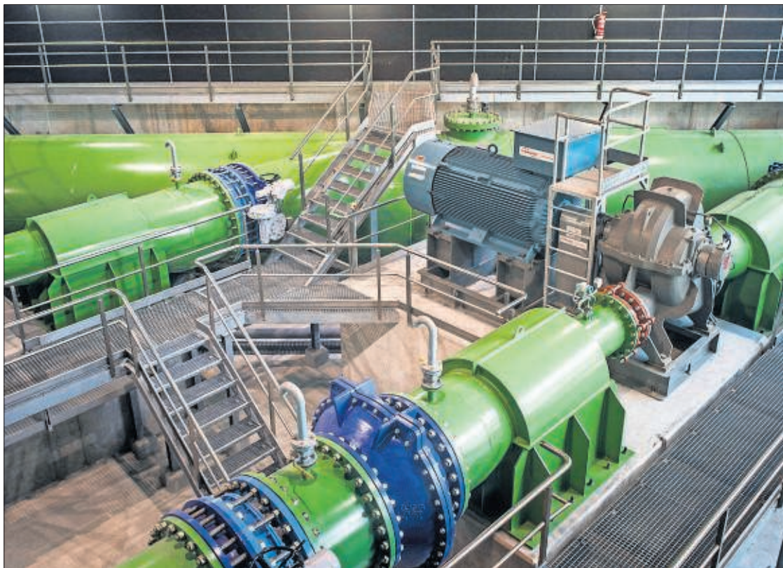
Estación de bombeo de la distribuidora de agua Fontsa de ATLL. / GIANLUCA BATTISTA
